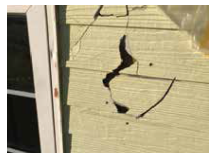
例：台風による飛来物でのサイディング破損
