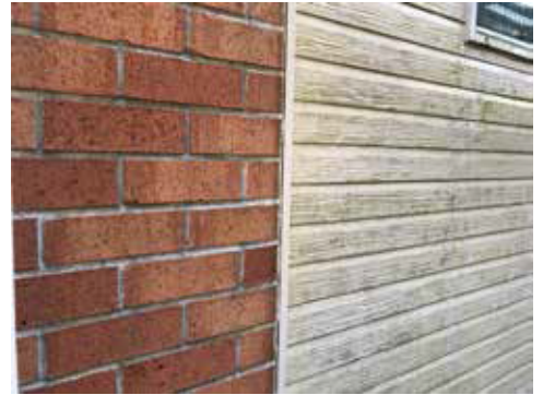
例：築10年、同じ北面にあたる外壁部。サイディングは3年前に塗装。 レンガはメンテナンス無し。
